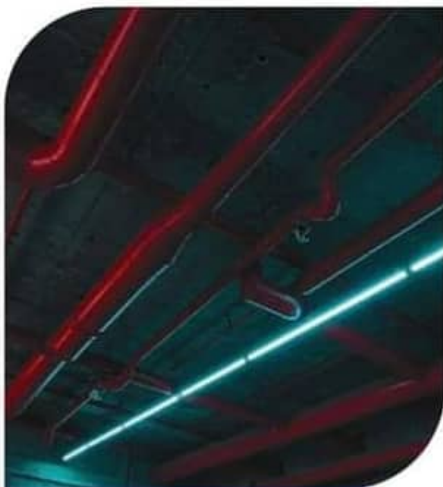
لأنظمة إنذار وإطفاء الحرائق (Firefighting Systems)
