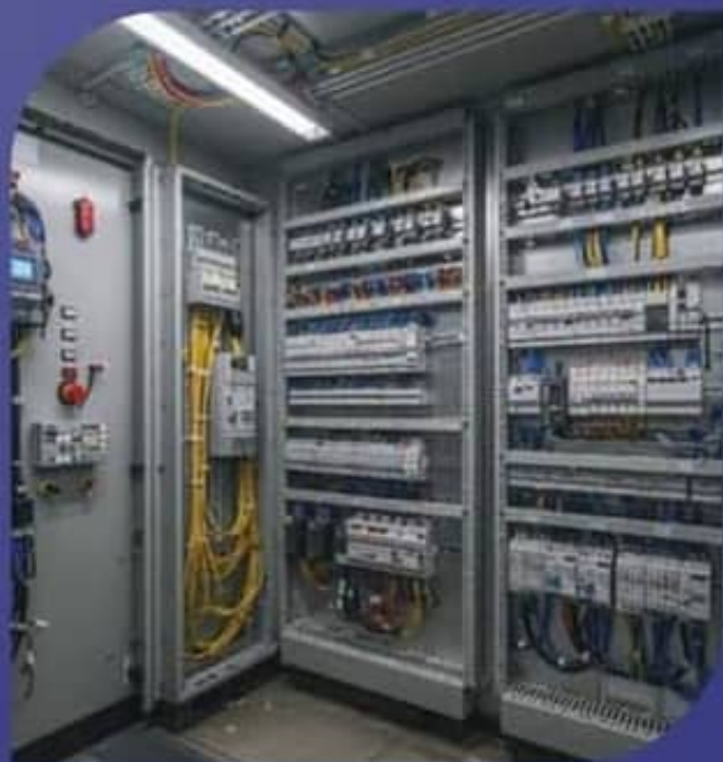
التمديدات الكهربائية والإنارة والتيار الخفيف Electrical & Low Current
